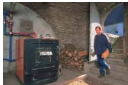
Ce sont les bûches, en rondins ou en quartiers, qui sont le plus utilisées dans les chaudières à bois, comme ici dans une vieille demeure de Franche-Comté.
