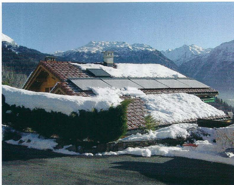
En Haute-Savoie, capteurs solaires installés par le réseau SOLEIL EN TÊTE.
